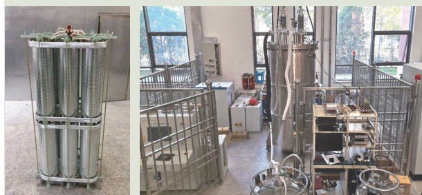
图5 (左)高温超导限流单元;(右)40 kV/2 kA超导直流限流器考核现场
