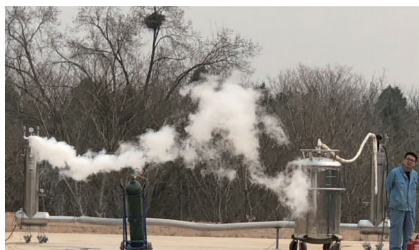
图1 氢电混输超导直流能源管道测试现场
