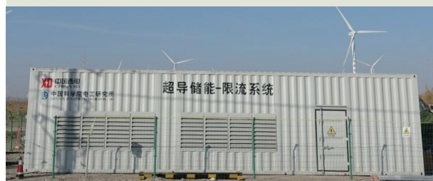
图 9 1 MJ / 0.5 MVA 超导储能—限流系统在玉门风电场并网试验现场
